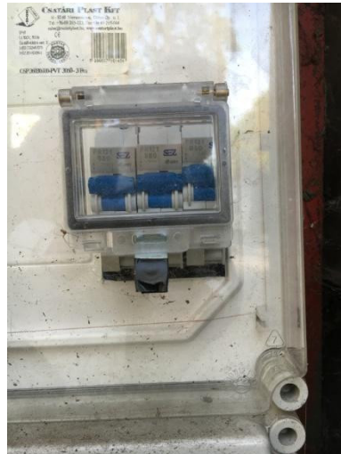
jelenlegi csatlakozási teljesítmény
